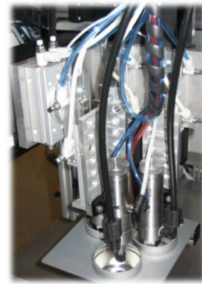
VÁLVULAS EN LAS CUBETAS DE APARCAMIENTO
